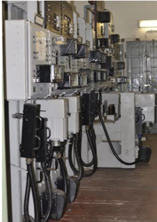
Ausgrid movable heritage switchgear
